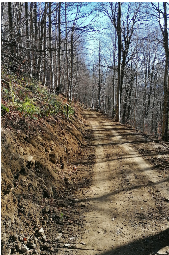
Remontowany szlak i droga dojazdowa do Schronu na Połoninie Wetlińskiej (fot. E. Amarowicz).
