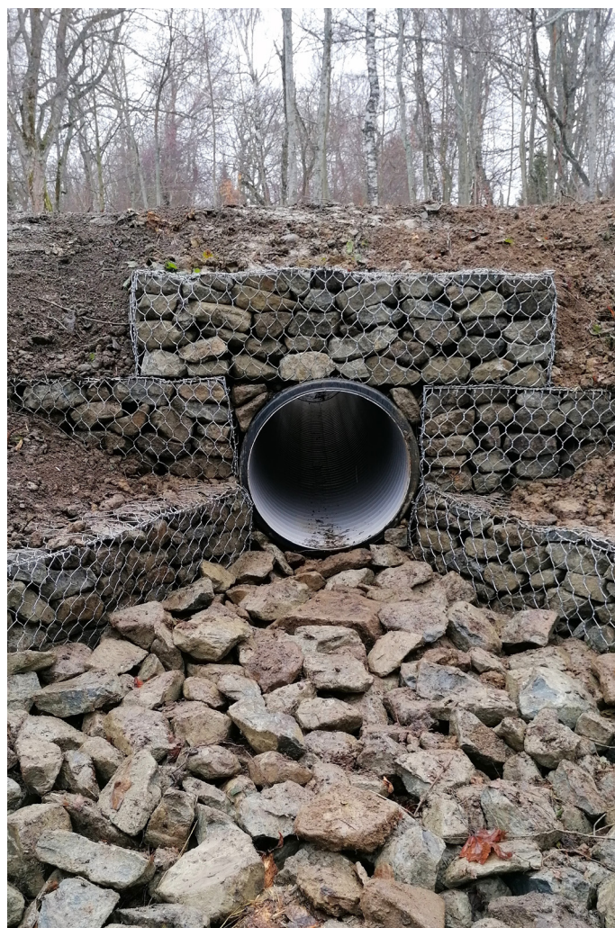
Wyremontowany przepust na szlaku z Wołosatego na Przełęcz Bukowską (fot. E. Amarowicz).
