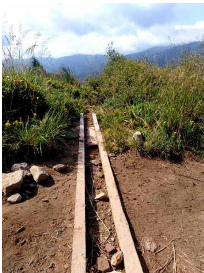
Dren odwadniający szlak (fot. R. Sidor).
