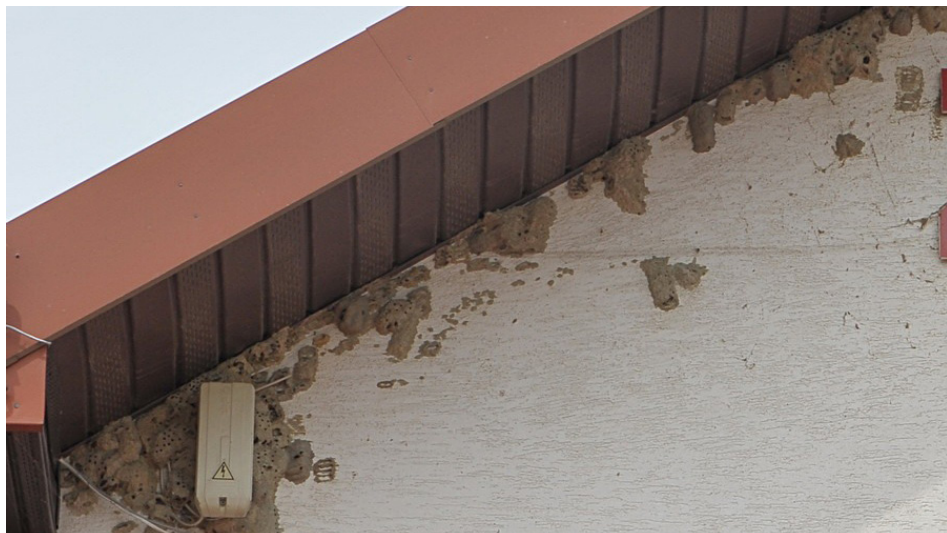
Ryc. 7. Gniazda Sceliphron destillatorium (Illiger, 1807) zaobserwowane w Tylawie, elewacja południowa, I piętro – fot. J. Bury.
