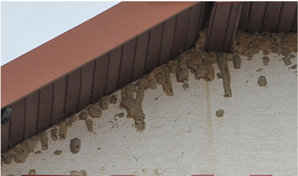
Ryc. 6. Gniazda Sceliphron destillatorium (Illiger, 1807) zaobserwowane w Tylawie, elewacja południowa, I piętro – fot. J. Bury.
