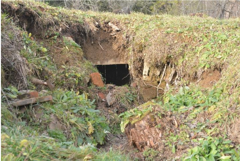
Ruiny podmurówki nieistniejącego dworu właścicieli Sianek – Stroińskich, które wymagają usunięcia roślinności I utwalenia ruiny – zadanie zaplanowane w mikroprojekcie.
